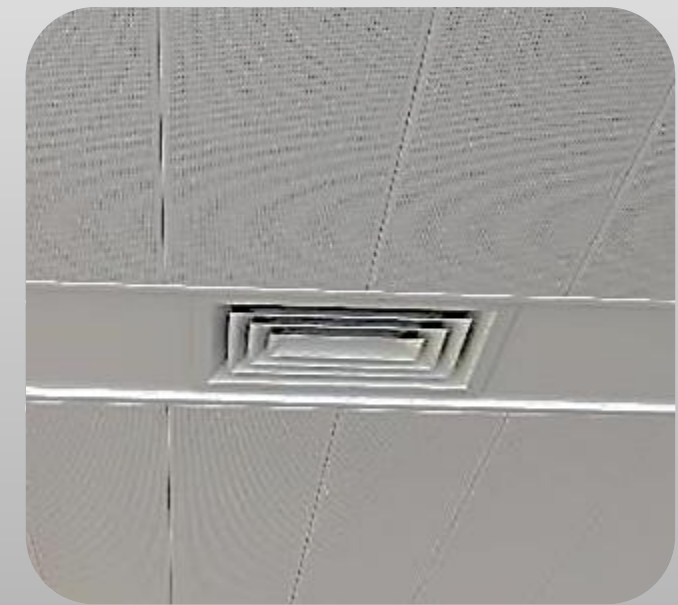
单元内集成铝扣板吊顶
